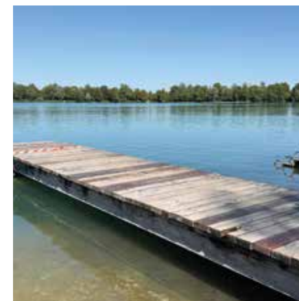
Der alte marode Steg wurde zwischenzeitlich gesperrt.
